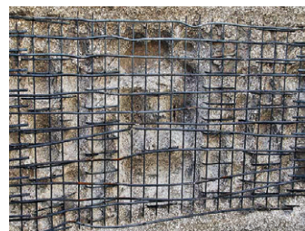
Degradace železobetonu při požáru
