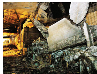
Tunel po požáru, v popředí shořelý kamion
