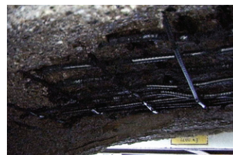
Detail výztuže po požáru
