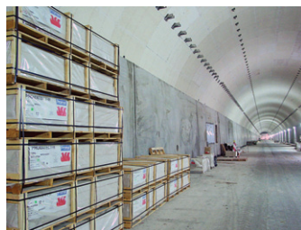
Ochrana tunelového tělesa pomocí desek PROMATECT®-H
