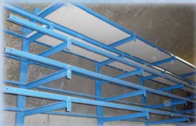
Příklad použití kalciumsilikátové desky PROMATECT®-H jako nehořlavé podložky pod kabely, odolávající také výboji elektrického oblouku.
