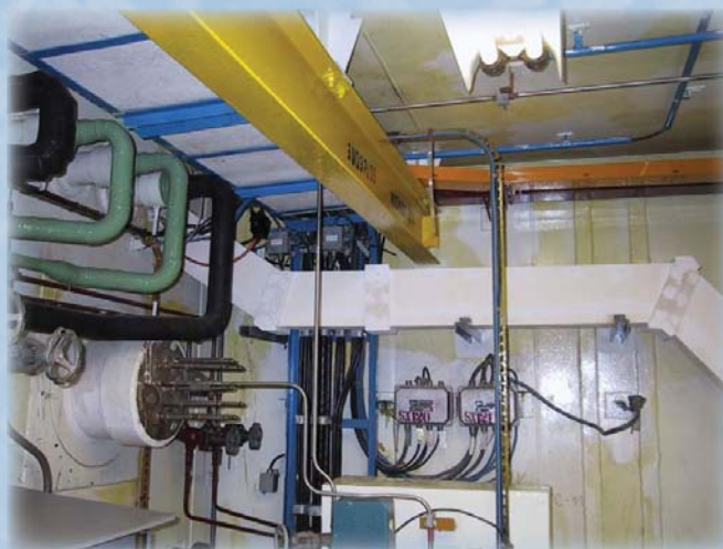
Kabelový kanál Promat - JE Dukovany
