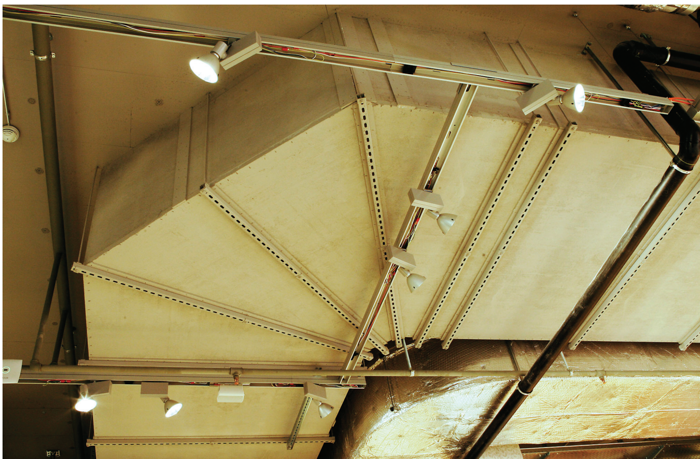
Ventilační potrubí z desek PROMATECT®
